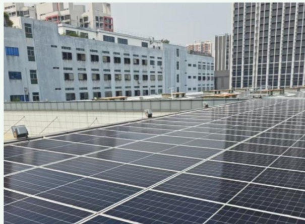
公司厂房屋顶光伏板
