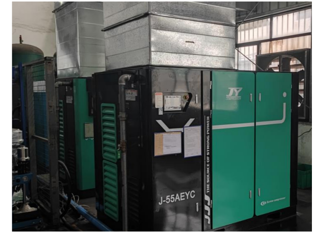
公司空压机系统
