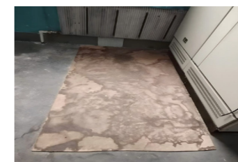
2025.3.4钣金车间配电室静电地毯失去静电作用
