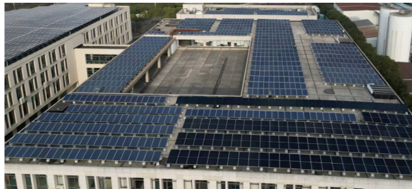
光伏发电设备
