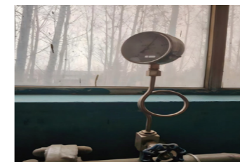
2025.3.4钣金车间喷涂燃气管道气体压力表无三色标识
