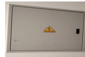
2025.3.5厨房配电箱危险标识张贴错误
