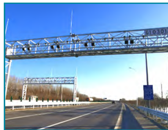
○ 道路ETC门架运维
