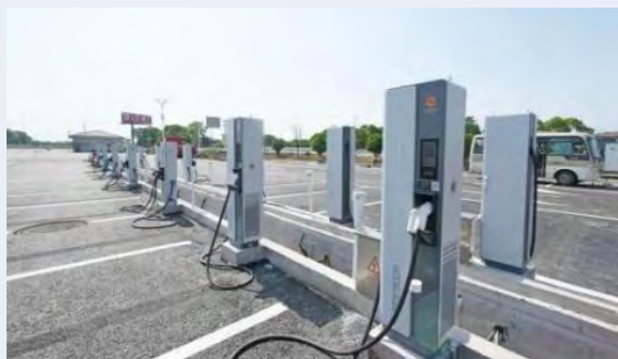
溇湖服務區新建新能源充電樁。
