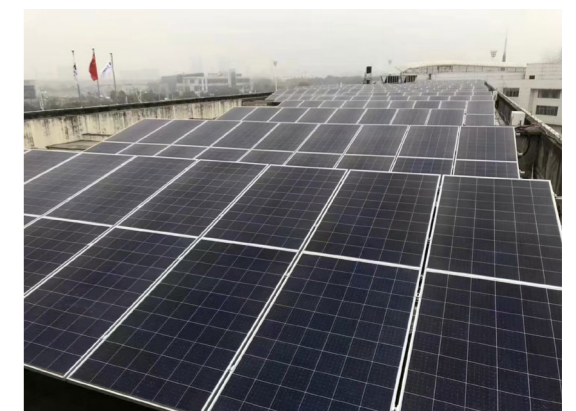
方山光伏项目
