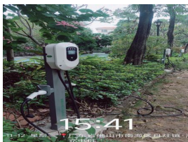
新能源汽車充電樁
