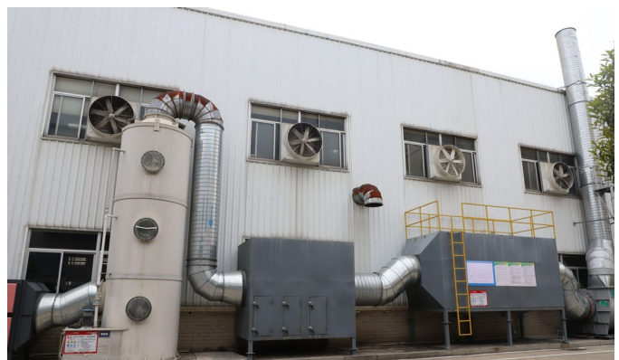
废气处理设备
