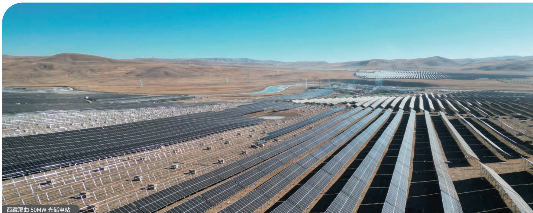
西藏那曲 50MW 光储电站
