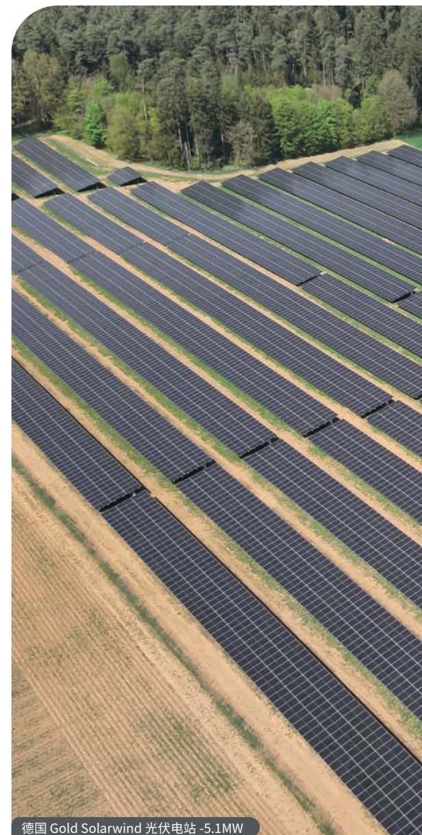
德国 Gold Solarwind 光伏电站 -5.1MW
