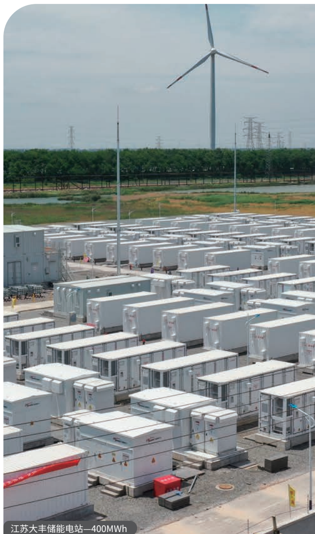
江苏大丰储能电站—400MWh
