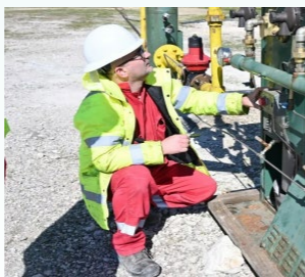
PM 油田热采项目第二台亚临界注气锅炉成功投运
