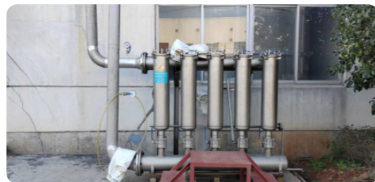
回用水总管上安装布袋过滤器
