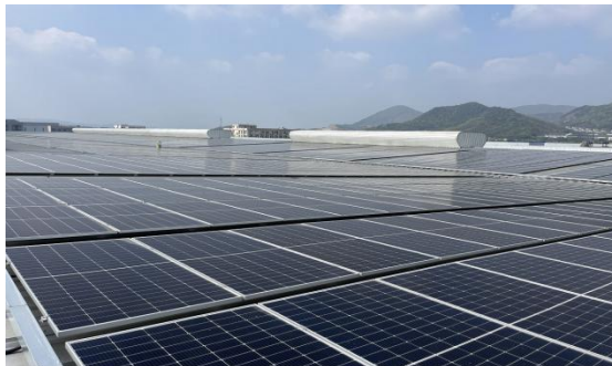
湖州新坐标光伏项目
