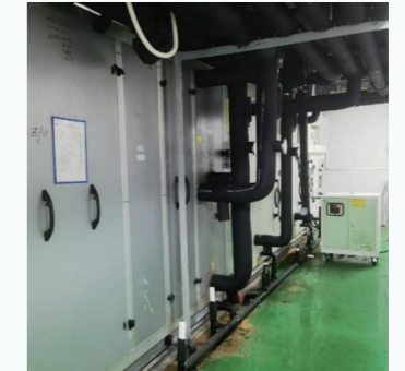
中央空调节能减排项目
