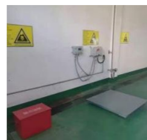
危废泄漏收集沟
