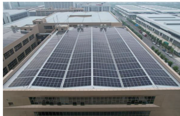
望海路工厂光伏
