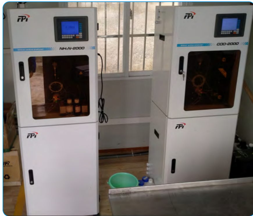
▲ 污水在線檢測設備
