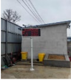
噪聲、揚塵監控系統
