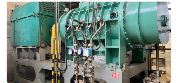
壓縮機高壓變頻器改造
