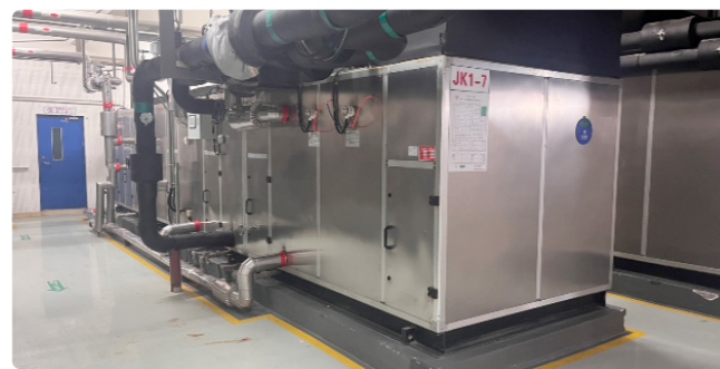
空調系統能量回收改造
