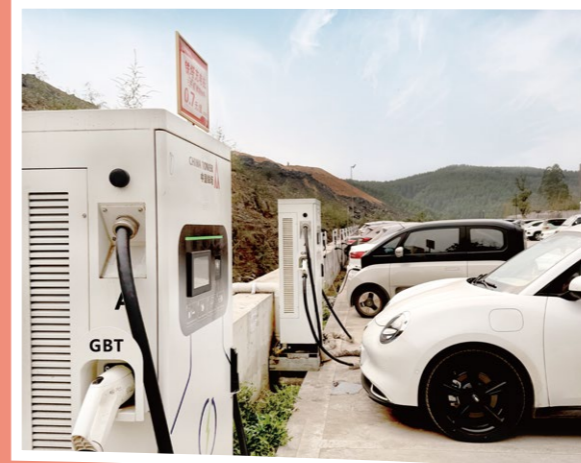
新能源汽车充电设施
