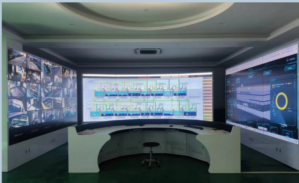
废水站先进中控室
