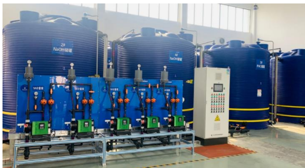
杭州临平自来水厂（2021）
