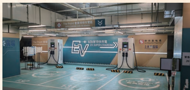
新鸿基上水广场充电桩项目
