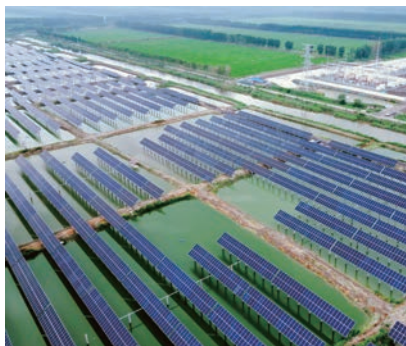
2024年12月，华润曹妃甸石化产业基地绿色低碳能源光伏发电项目首批250兆瓦光伏发电单元并网发电
