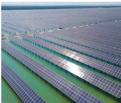
2023年7月，国家第一批大基地项目——华润财金红光渔业800兆瓦光伏发电项目全容量并网
