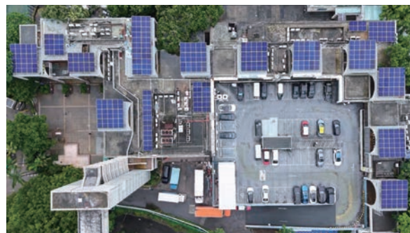
华润电力香港英皇穗禾苑 150kWp 分布式光伏项目，是华润电力与英皇国际在可再生能源领域合作的首个试点，于 2025 年 8 月实现全容量并网
