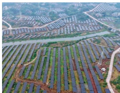
2025年12月，江津龙华（一期）300兆瓦 光伏项目倒送电一次成功
