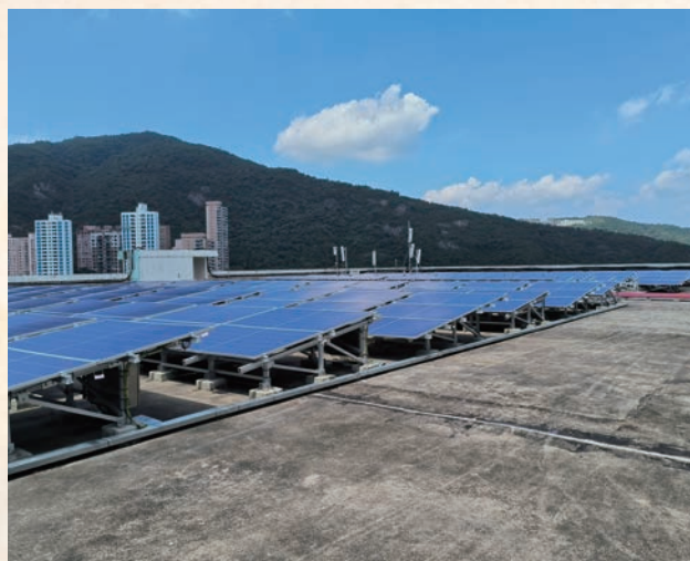
香港华润物流720kWp分布式光伏项目位于香港沙田区，是华润电力首个在港项目，自2020年6月以来年均提供清洁电能67万千瓦时
