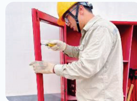
消除消防隱患
