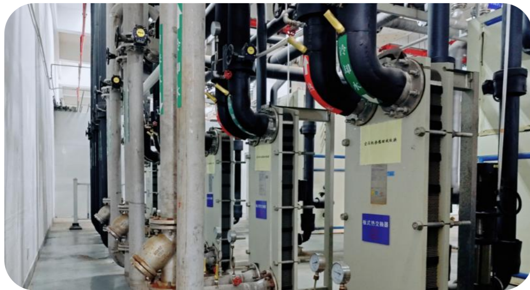
空压机余热回收系统
