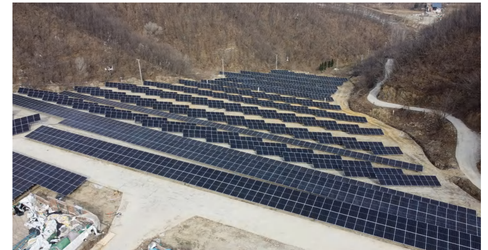
嵩县金牛公司储能电站和光伏发电项目的建设有效提升了公司绿电比例，为平滑用电负荷、降低用电成本、参与碳交易奠定了坚实基础。
