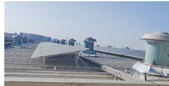
新华制药厂区立体库光伏系统
