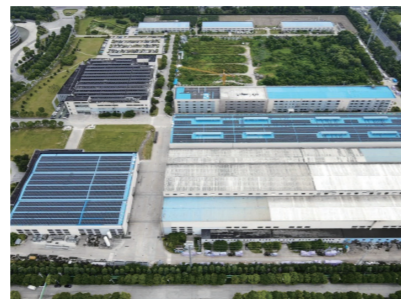
总部园区 3.1MW 屋顶分布式光伏
