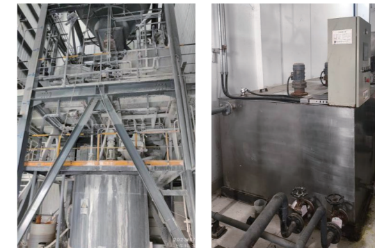
石灰浆制备系统
