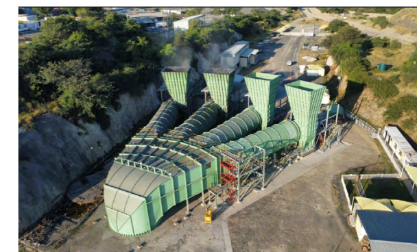
完工的地面通风井风机
