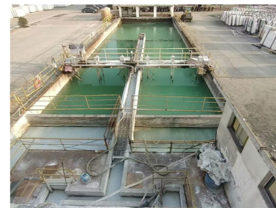
江西新凤微晶玉石有限公司废水经沉淀、过滤处理后实现回用
