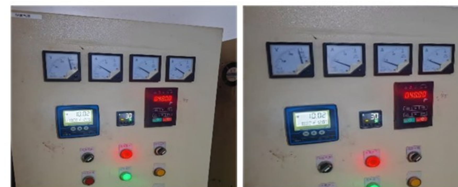
风机变频器调整前
