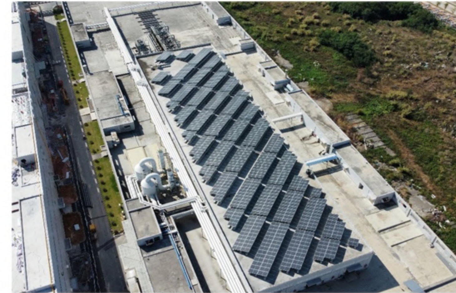
光伏节能设施
