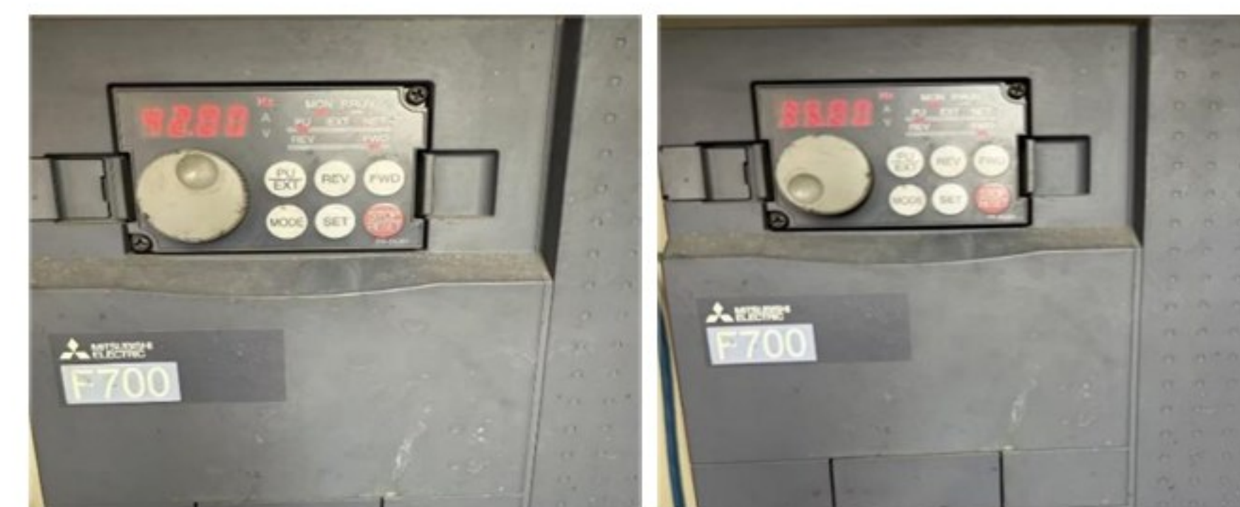
风机变频器调整前
