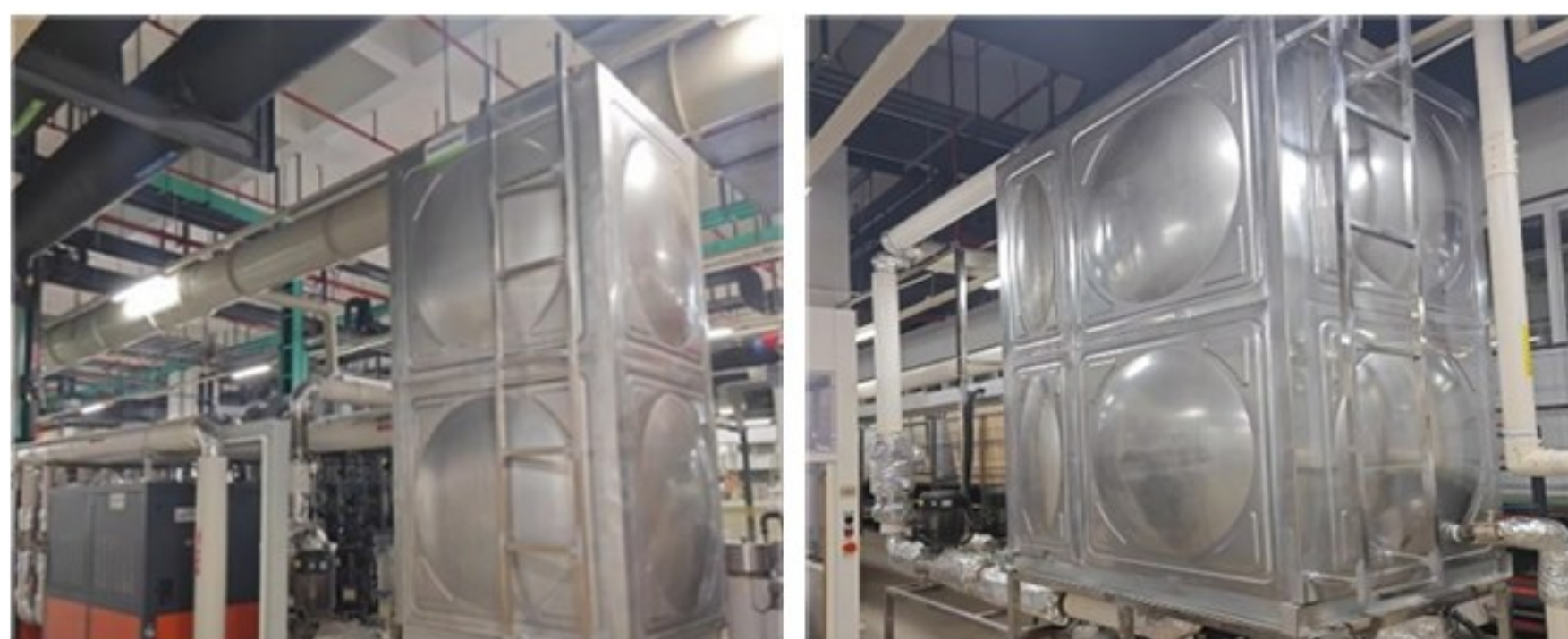
沉铜线增加高温热泵项目
