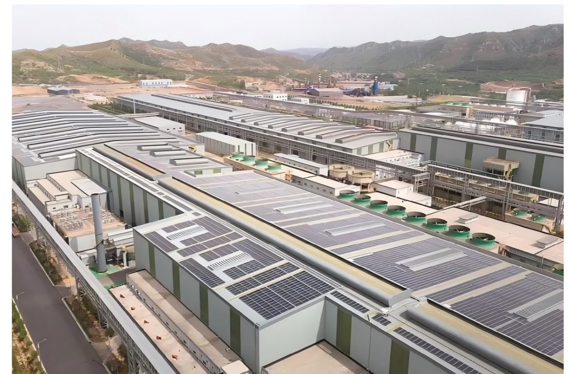
屋顶光伏发电板 Rooftop PV panel
