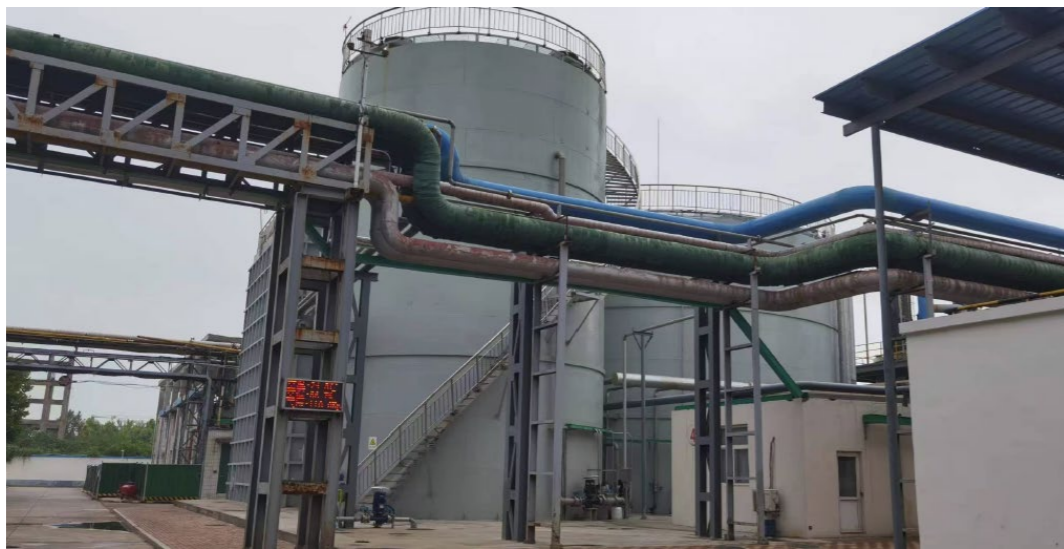
圖：石藥創新廢水治理設施
