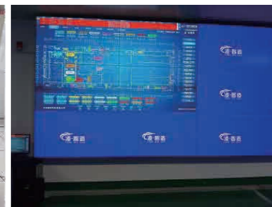
动力设备运行智能监控平台
