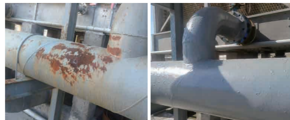
安全隐患排查整改
