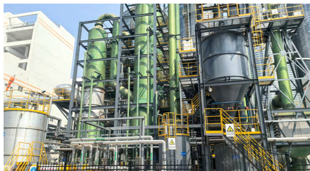
冀中新材废气治理设施
