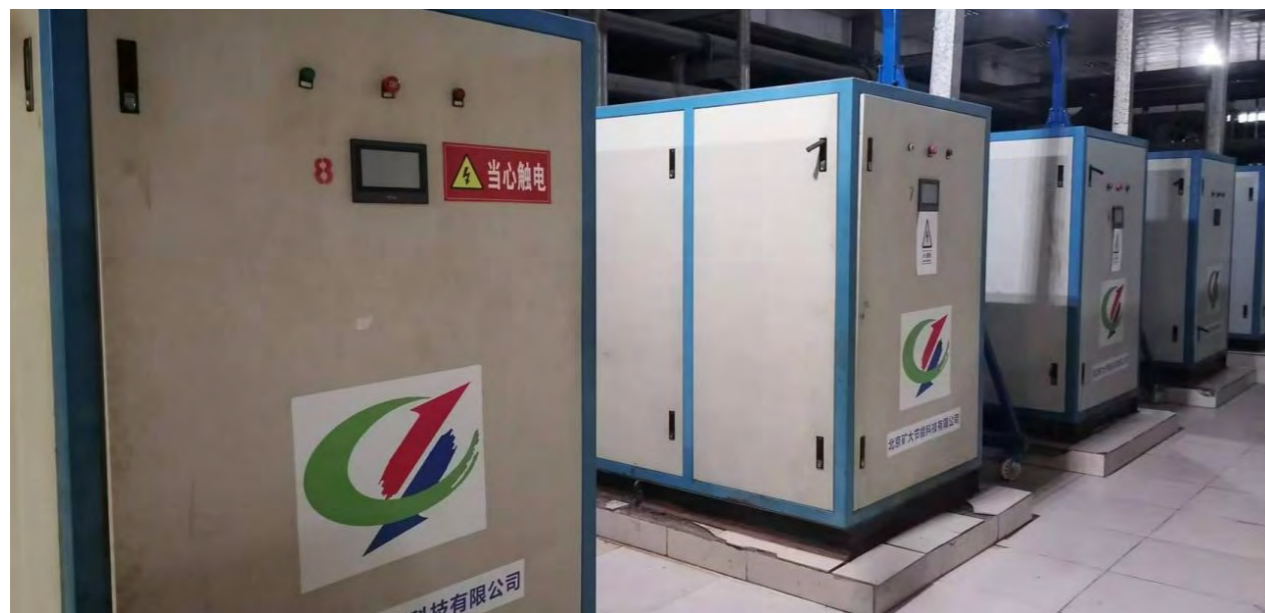
章村矿水源热泵系统升级改造项目水源热泵机组，提高设备运行保障能力，年可节电 16.45 万度
