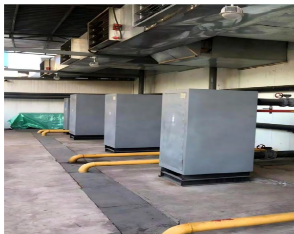
邢东矿压风机升级改造项目压风机变频设备
