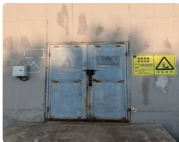
吉林分公司危险废弃物存放室
