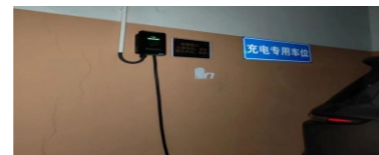
公司生产基地内设立了多个新能源汽车充电桩
