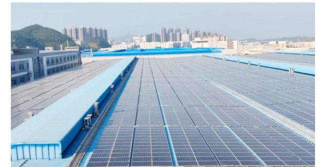
光伏发电项目
