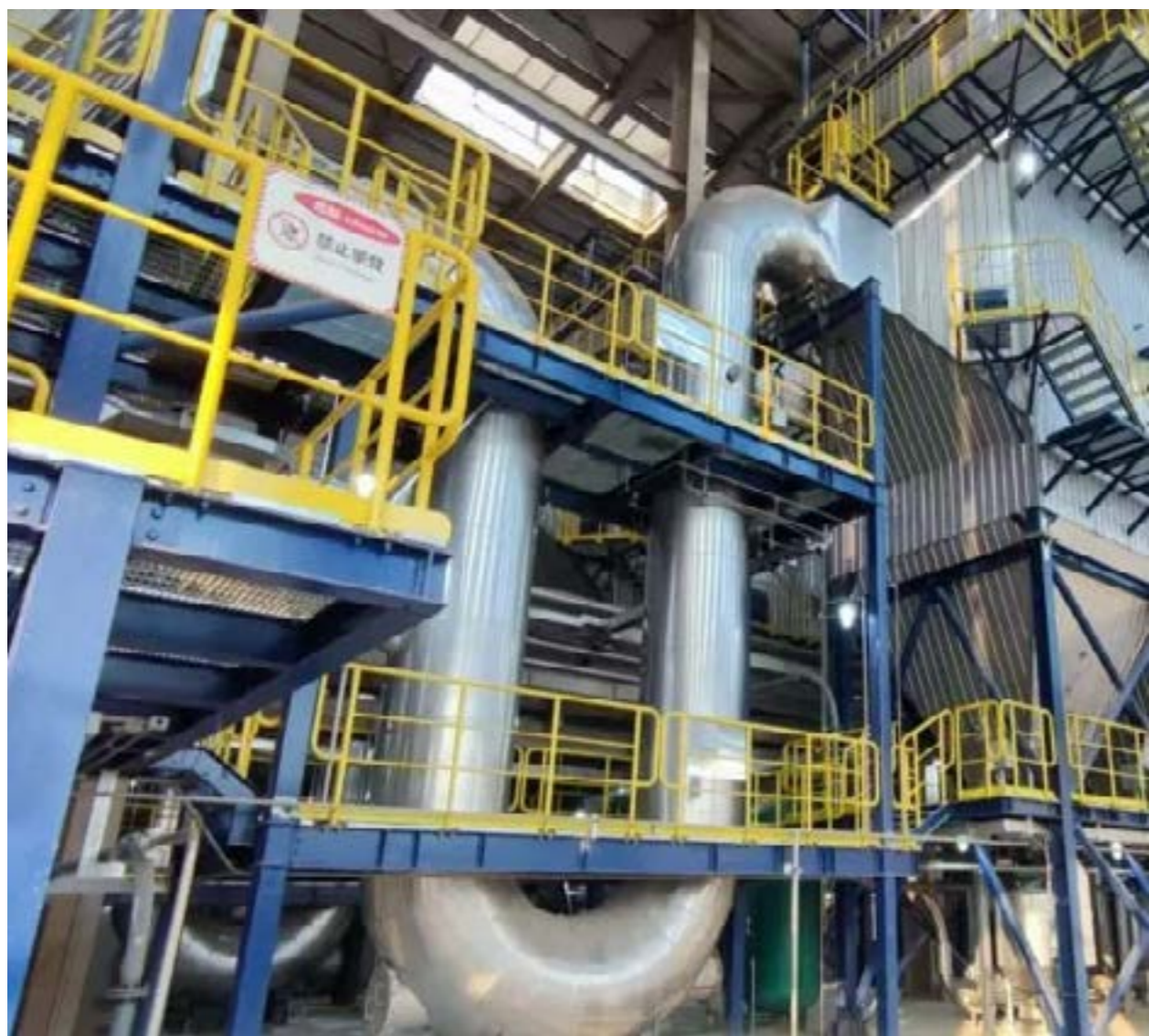
成都污泥焚烧项目内部
