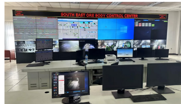
赞比亚谦比希铜矿东南矿区控制中心
