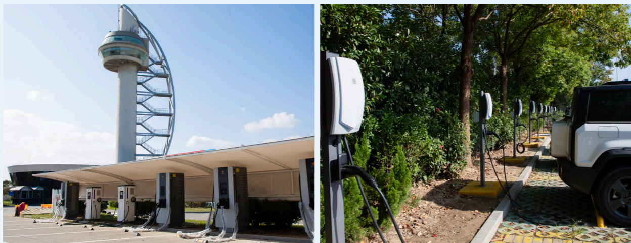
公司内部充电设施
