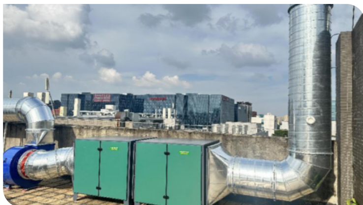
废气治理主要设施
