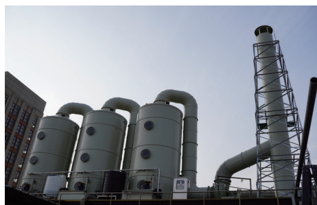
亞東常州污水站廢氣處理裝置改造後
