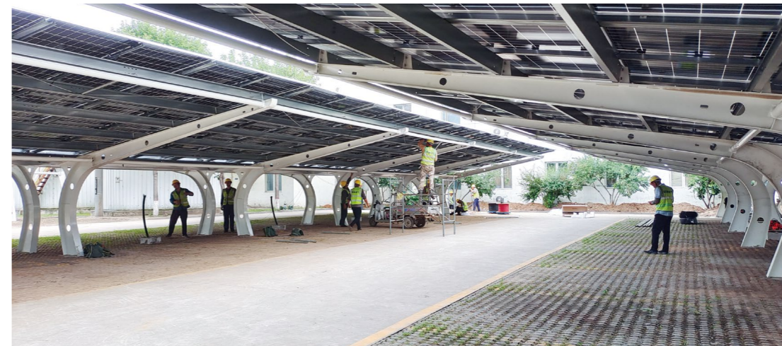
承德热电厂区分布式光伏项目
