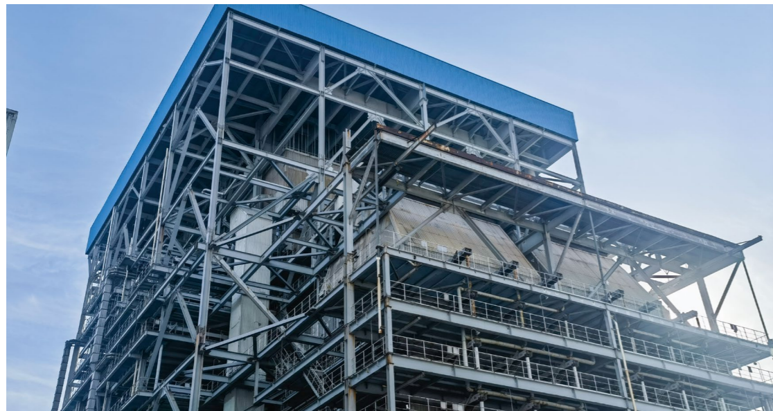
沙河电厂全负荷脱硝项目
