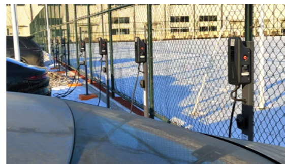
公司建设新能源充电桩，满足员工新能源汽车充电需求
