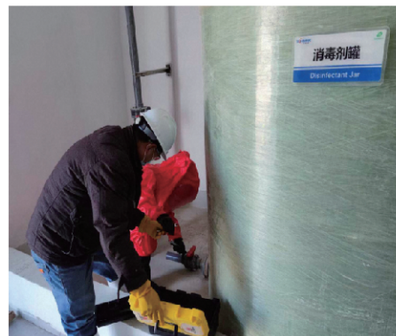
次氯酸钠泄漏应急演练
