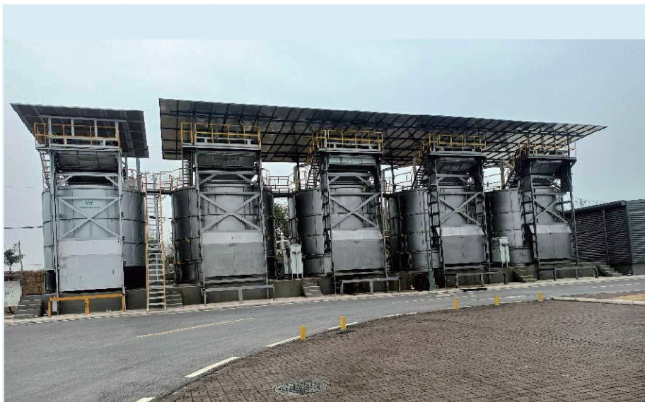
有机肥发酵罐
