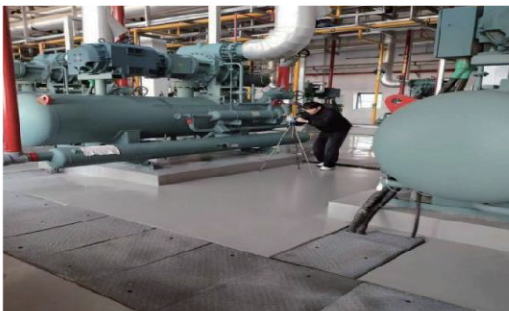
拾分味道制冷机房职业危害因素检测
