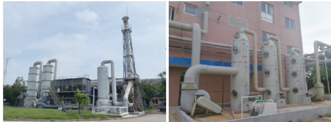
废气处理设施
