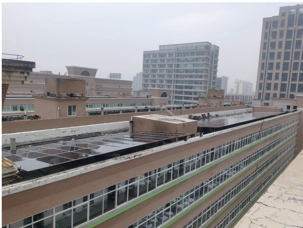
光伏發電設備
