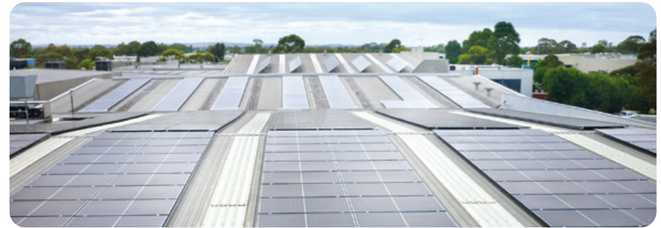
在Keysborough廠址使用太陽能板
