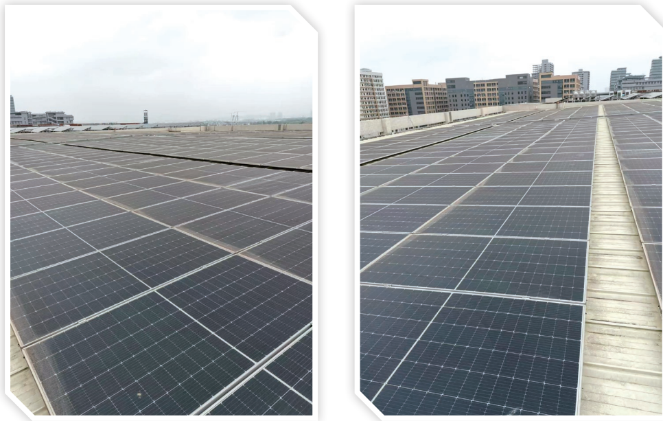
屋頂光伏發電
