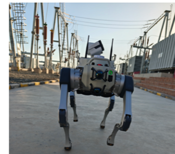
四足机器人巡检升压站设备
