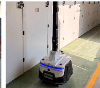
轮式室内机器人巡检高压配电室设备
