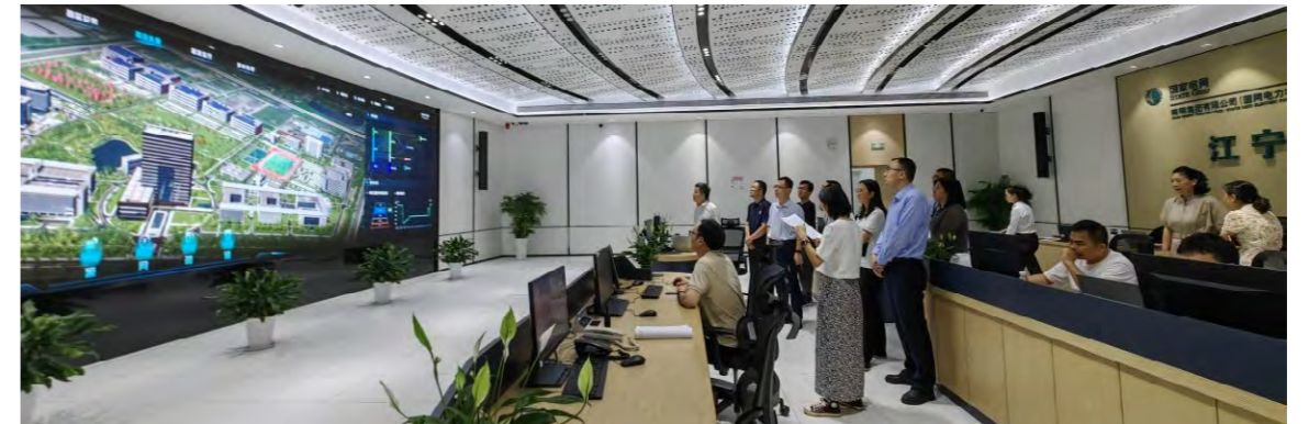
智慧运营管理平台后勤运行监控中心
