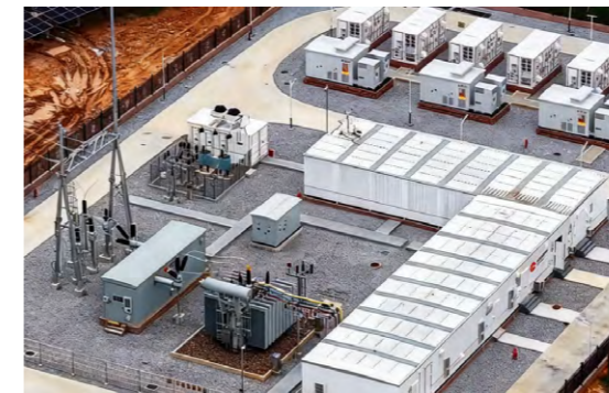
农光互补光伏发电项目升压站全貌
