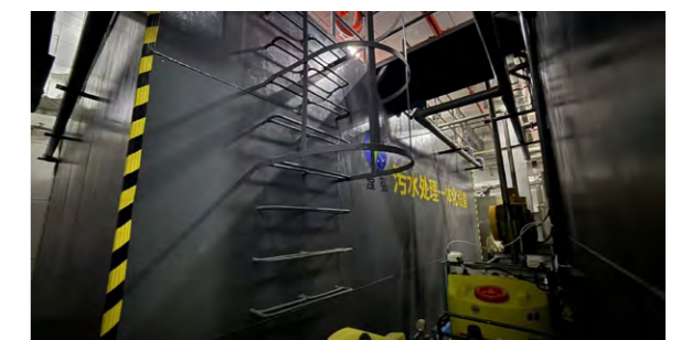
南瑞继保食堂污水综合治理升级项目
