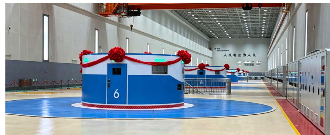
电站 6 号机组正式投入商业运行
