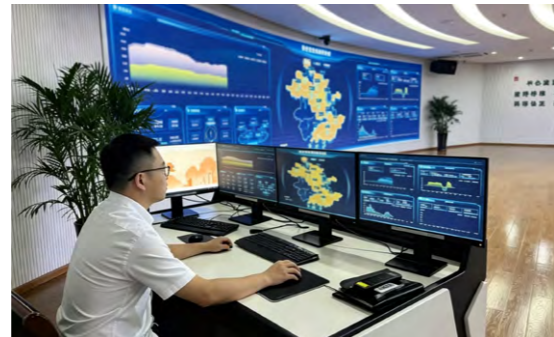
国电南瑞技术人员通过新型电力负荷管理系统监测活动期间实时负荷情况
