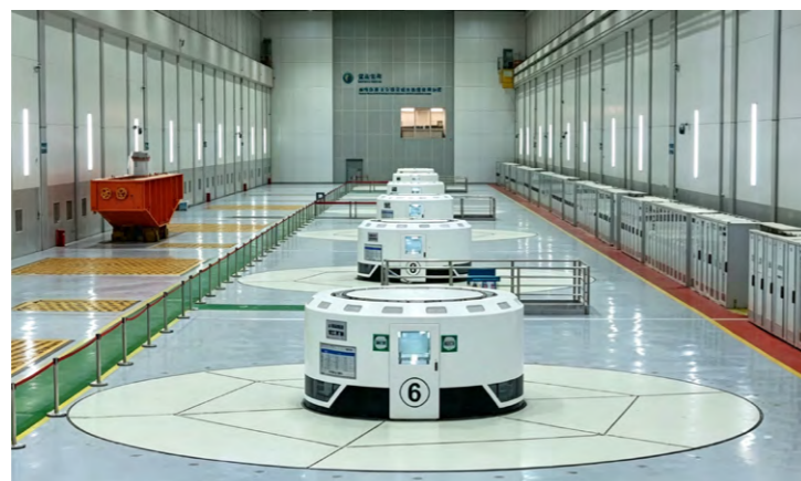
辽宁清原抽水蓄能电站内景
