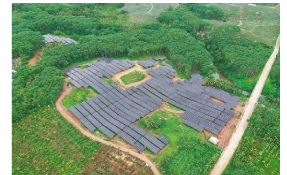
农光互补光伏发电项目光伏区
