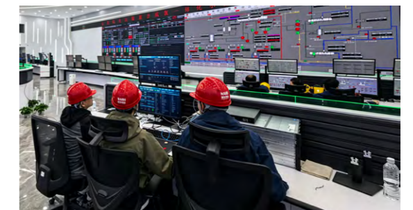
国电南瑞技术人员在调试现场
